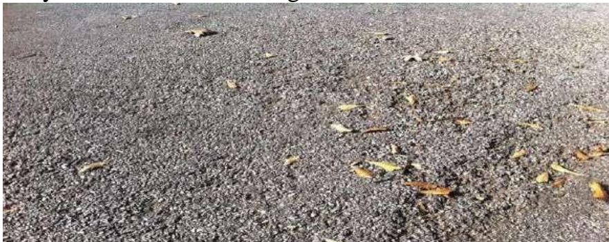
Fig. Raveling (very porous asphalt)
