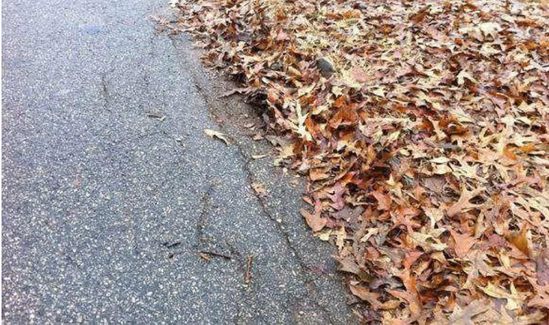
Fig. Edge Cracks
