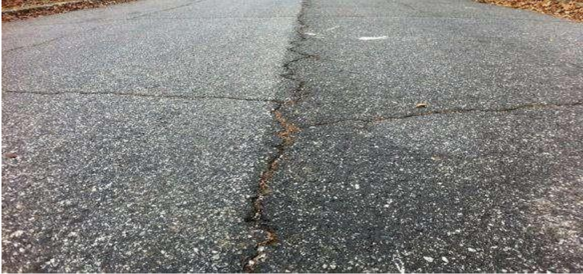
Longitudinal (Linear) Cracking
